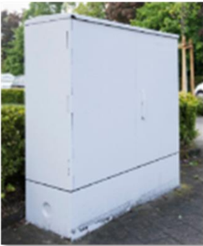
Abbildung 3: Beispiel für einen Oberflurschrank zur Aufnahme von Erdungsschiene und Linkbox (Quelle: TransnetBW, Stand 2018)
