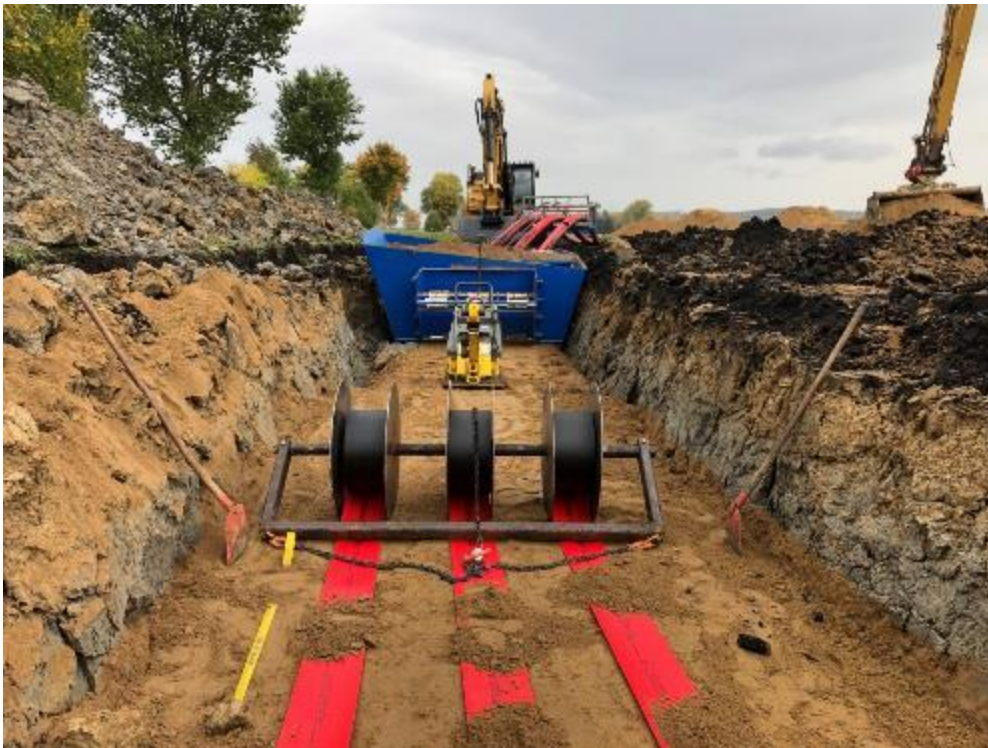
Abbildung 10: Ansicht Trenchbox aus dem Graben ACProjekt (3 Schutzrohre statt 2 bei DC) (Quelle: TenneT)
